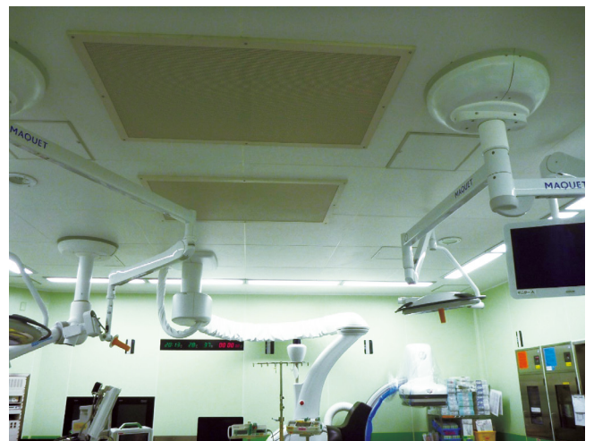
図2. ヘパフィルタの下を遮るものは皆無で、清浄度の高い手術室
